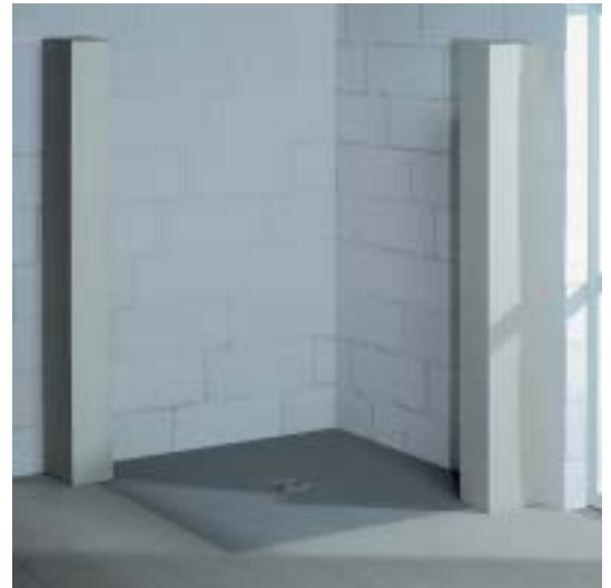
Bild 14: Barrierefreie Duschanlage z. B. mit Illbruck Fertigelement und Dallmer Bodenablauf.
