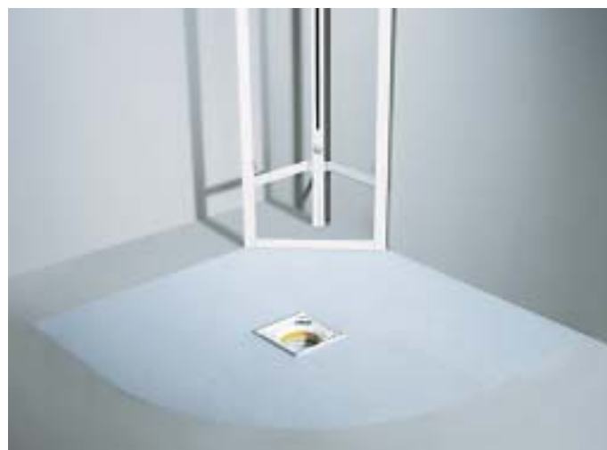
Bild 4: Barrierefreie Duschanlage z. B. mit Illbruck Fertigelement und Dallmer Bodenablauf.
