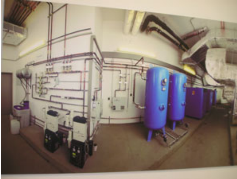
Bild 2: Beispiel einer Zentrale für medizinische Gase
