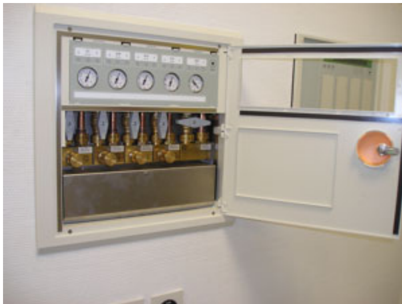
Bild 4: Beispiel einer Bereichskontrolleinheit mit Absperrung von diversen med. Gasen und Möglichkeit der Noteinspeisung , Werkbild ©Dräger Medical ANSY GmbH.
