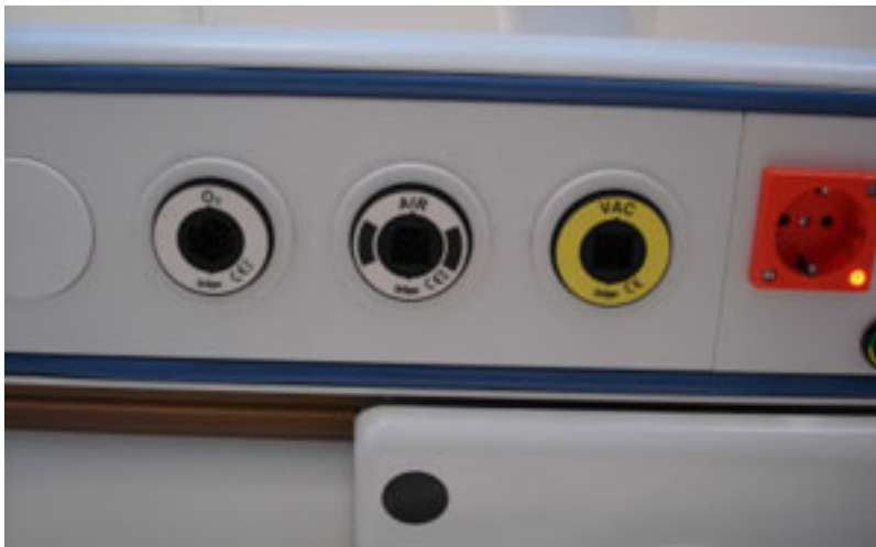
Bild 6: Anschlussmöglichkeit für medizinische Gase an Versorgungseinheiten der Frühgebohrenstation, Werkbild ©Dräger Medical ANSY GmbH
