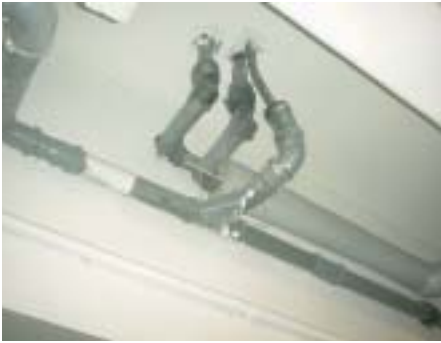
Bild 8: Durchführung einer Splitanlage
