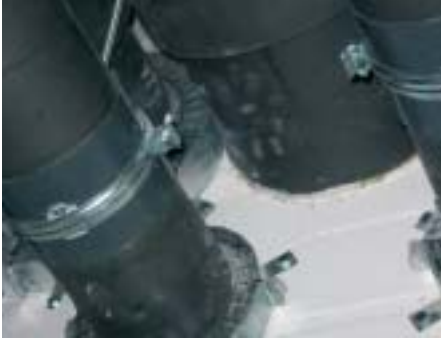
Bild 11: Abschottung von brennbaren PE-HD-Kälteleitungen mit R90-Brandschutzmanschetten
