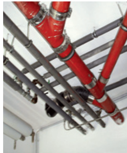
Bild 5 · Brandschutztechnische Probleme mit der Mischverlegung – Beispiel aus einer Großküche. Wichtiger Hinweis: Hier sollte neben der Dokumentation des Mangels auch ein Lösungsvorschlag beschrieben werden.
