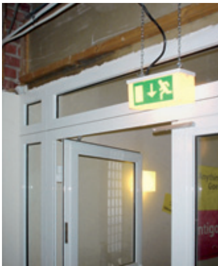
Bild 3 · Bauteilmangel oberhalb der T 30-RS Tür, statt F 90 = keine Feuerwiderstandsdauer.
