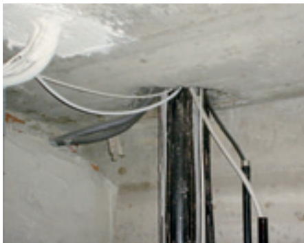
Bild 2 · Mangel an Leitungsdurchführungen Der Mangelanteil der TGA liegt bei Bestandsbauten bei 60-80% der in der Praxis dokumentierten Mängel.
